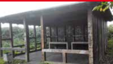
Trauriger Zustand der Grillhütte am Blessemer Lichweg
